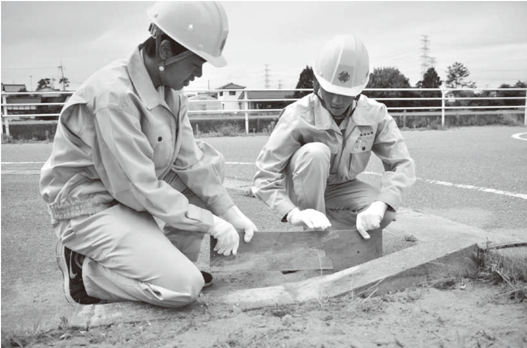
▲聖籠中学校に隣接する歩道の境界ブロックを修繕する作業の様子。写真左が稲田さん、右が高橋さん。ずれたブロックを元の位置に戻し、コンクリートで固めた後、型枠を外します。
