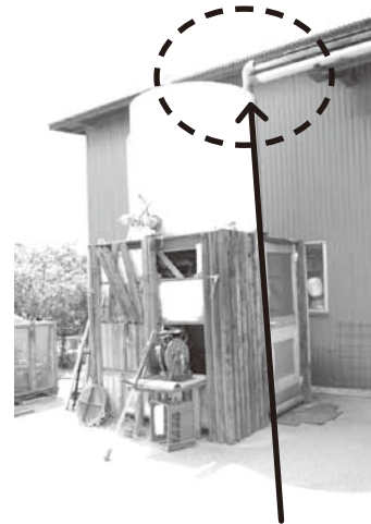
3 m 3 貯まる雨水タンクを 雨どいに繋げています
