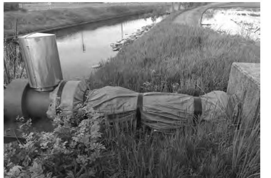
▲待たれる本復旧工事（網代浜の茨島）
