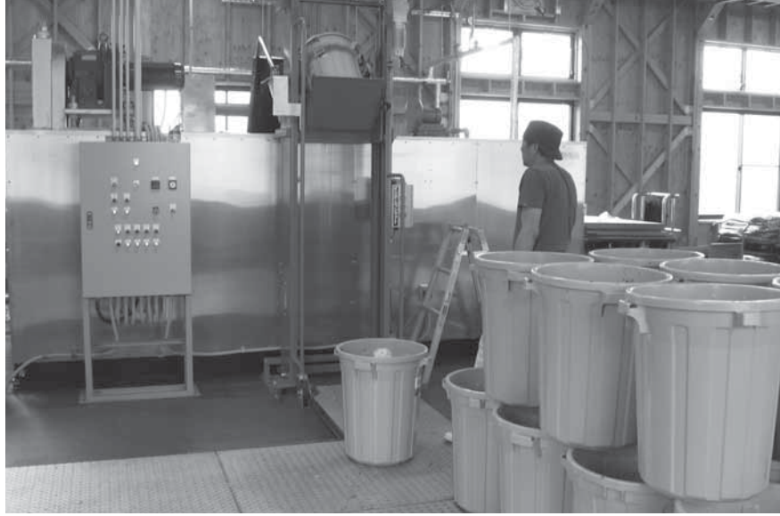
▲全町対応まがか生ごみ処理施設
