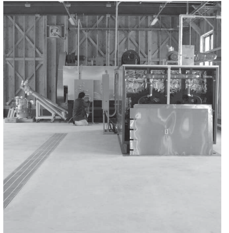
稼動が待たれる大型生ごみ処理機
