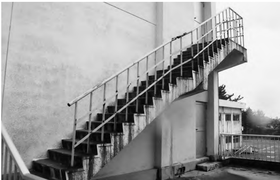
▲老朽化が進む亀代小学校
