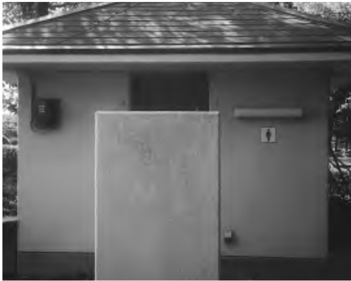
▲改修が望まれる公衆トイレ
