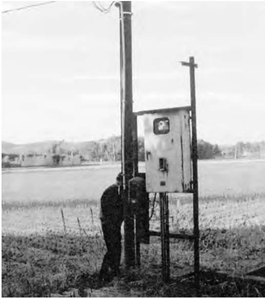
▲ 下新保地区のかんがい施設
