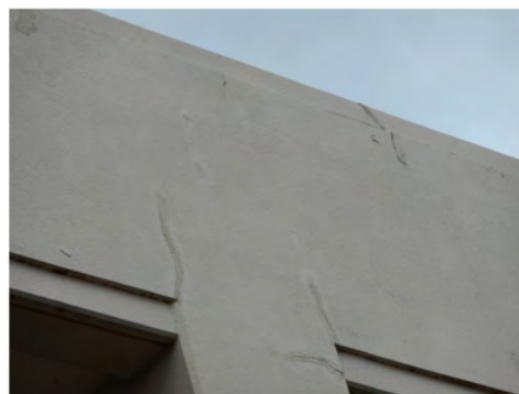
柱・梁部の構造クラック補修箇所
