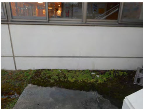
腰壁・土台部の構造クラック箇所
