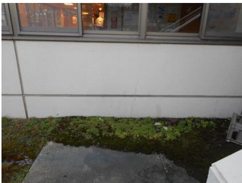
■ 腰壁・土台部の構造クラック箇所
