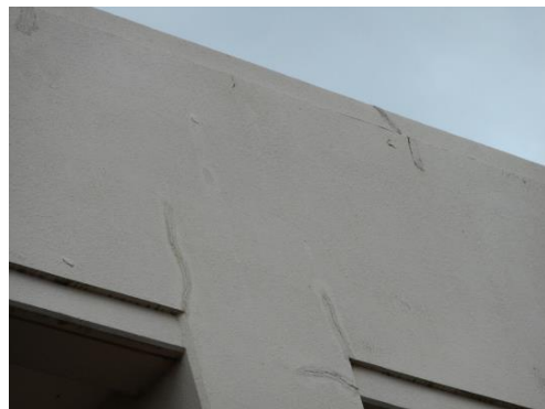
■ 柱・梁部の構造クラック補修箇所
