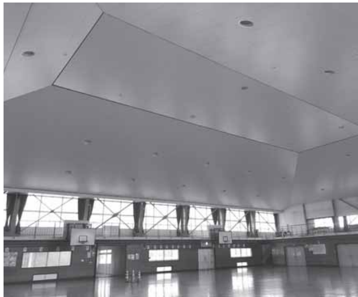
▲いち早くつり天井の撤去を
